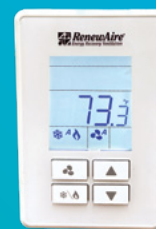
Contrôle du ventilateur BACnet
